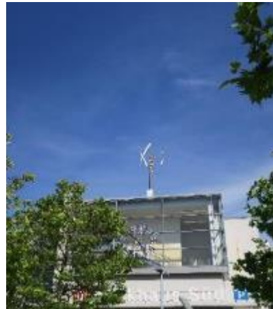
圖 4-14 科技園區內公司屋頂上的風力發電器
