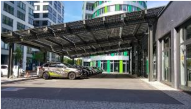
圖 4-39 屋頂使用太陽能板，該電能可供給棚下的電動車充電用。
