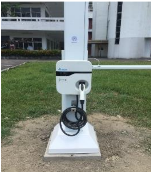
圖 4-67 園區內台達電設置的電動車充電站
