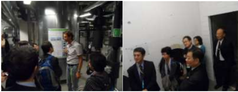
室內環境管理員解釋溫差空調設計之原理並參觀地下管道
